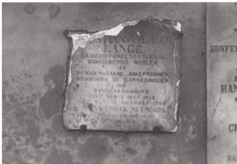
En marmortavle med korrosion og frostsprængninger. Afskalninger i vinteren 1987-88 er sket på de hvide steder. (Foto: A. A.).
