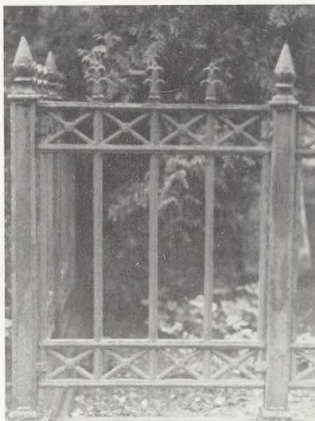
Gitterværk af geometriserende type, fjeder og not samling, som har måttet repareres ved lasker, sokkel af tredelt type.
