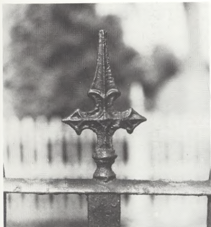
Topstykke i støbejern, anvendt som afslutning og pynt i et smedejernsgelænder. (Foto: AHM).
