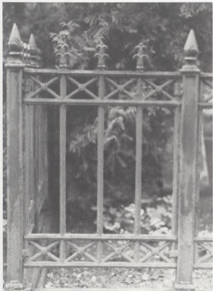
Gitterværk af geometriserende type, fjeder og not samling, som har måttet repareres ved lasker, sokkel af tredelt type.
