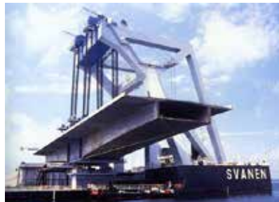
Montage af præfabrikeret broelement for Vestbroen i Storebælt på ca. 6.000 t med flydekranen "Svanen". Vestbroen er udformet som et unikt samlesæt af 324 elementer af pille-sænkekasser, søjler og brodragererlementer fabrikeret på land og placeret på brostedet med den specialbyggede "Svanen" Foto: Sund & Bælt.
