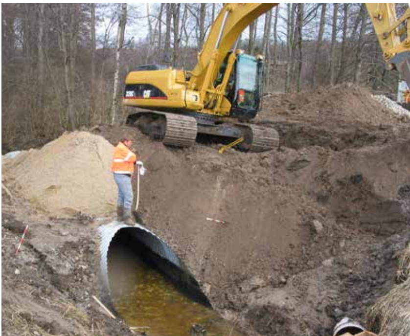
Fig. 9: En stenkiste nedlægges. Præstebro over Damvad Å mellem Ganløse og Slagslunde. Øverst et bjerg af sten i vejkanter. Nederst det nye gennemløb etableres. Foto: Preben Stenalt, 2004, Egedal Kommunes Lokalkiv.
