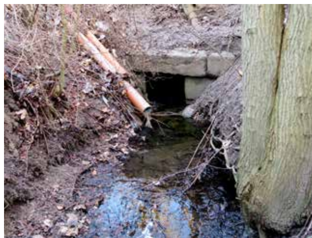
Fig. 8: Stenkiste nr. 4 over Brådebækken ved Ubberød Dam. Østsiden med skæmmende rør af plast. Foto: Per Lotz.
