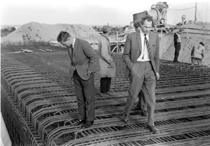
En vigtig del af al byggeri er kontrol med arbejdet. Her ses en inspektion af bro nr. 13 ved Skovsø ved Slagelse i 1961 i forbindelse med byggemøde.
