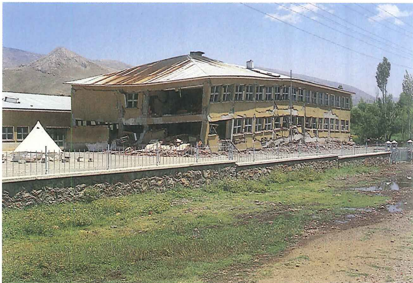
Figur 1. Bygning i en jordskælvsramt by i den østlige del af Tyrkiet. Skaderne stammer fra et forholdsvis lille jordskælv i 1986. Foto: Henrik Stendal.
