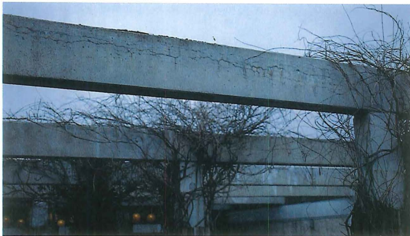
Figur 4. Pergola-bjælker med revner dannet ved alkali-kisel-reaktioner og senere udvidelse ved frysning.
