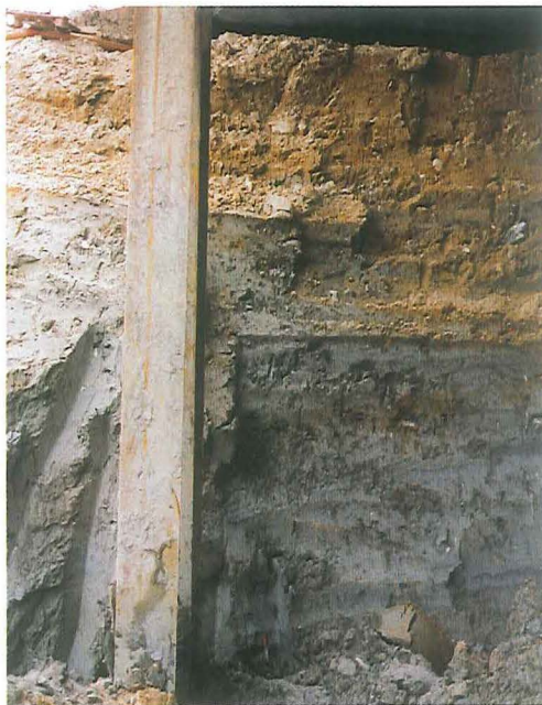
Figur 2. Profil i jordlagene ved det vestlige mellemfundament. Endefundamentet er funderet på lange pæle. På det tidspunkt, hvor fotoet er taget, bliver selve broen båret af stålprofiler nedrammet til ret stor dybde.
