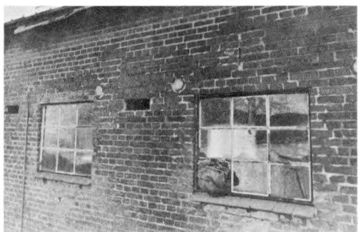
Fig. 5. Sålbænkene er ikke tætte, og der er ikke dugafløb fra vinduer. Herved ophobes fugt i væggen.
