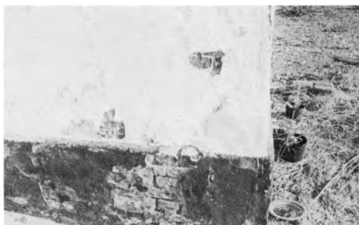
Fig. 2. Sokkel og fundament der kræver dybtgående renovering.
