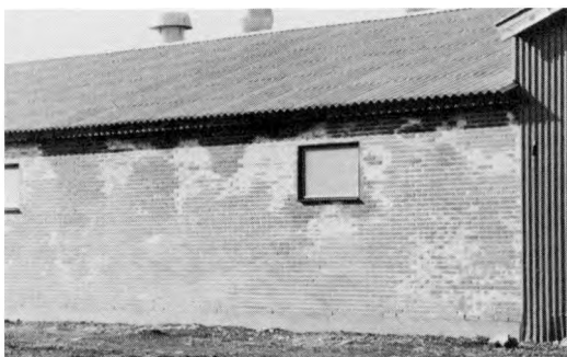
Fig. 3. Salpeterudslag der skyldes fugt i væggen. Efter udtørring skal imprægneres.
