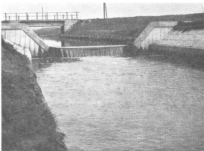
Styrt i den regulerede Brede Aa nord for Tønder. I højre side er indbygget et ålepas.
