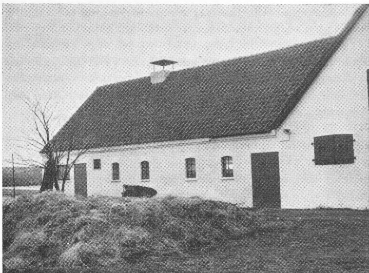
Fig. 6. Ventilationsskorstenen er her ført lige op og afdækket med en vandretliggende plade. Skorstenen burde være ført noget højere op, ligesom afdækningspladen burde være noget større.
