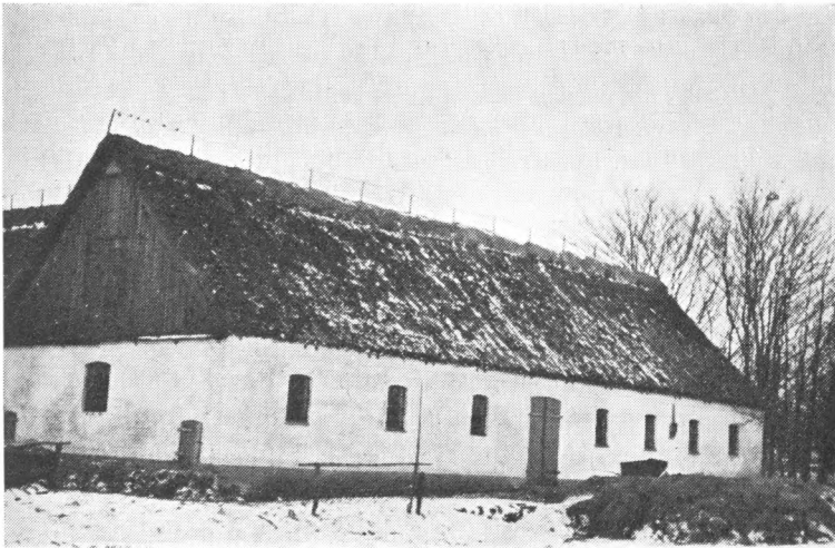
Fig. 2. Staldlængen set fra nordøst. På såvel gavlen som facaden er muren meget mørk og fugtskjoldet – i væsentlig højere grad end det fremgår af billedet. Et typisk udseende for en stald, der er dårligt isoleret og ventileret.
