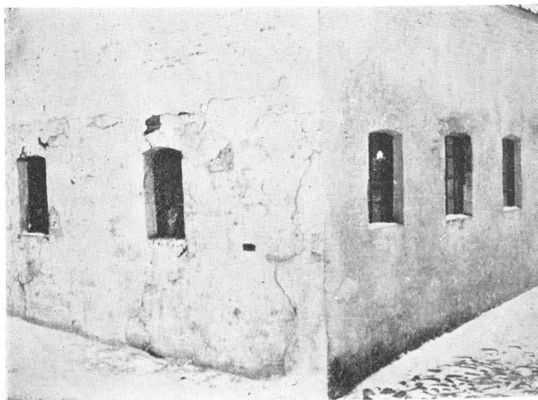
Fig. 6. Staldhjørne med fugtskjolder og frostsprængninger.
