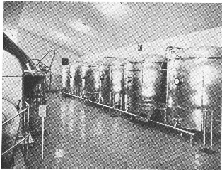
Fig. 1. Syrningstanke på kærnecentralen ved Hjørring
