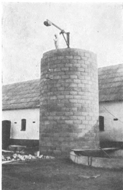
Fig. 4. Tårnsilo på Vejstrupgaard pr. Sjølund (Th. Vind Thomsen), bygget af fabriksstøbte betonsten. Siloen under opførelse ved hjælp af det særlige stillads og hejseværk.
