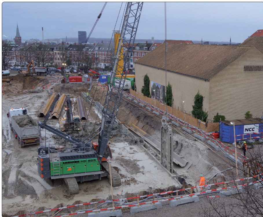
I øjeblikket er der ved at blive konstrueret en 18 meter dyb slidsevæg på byggepladsen ved siden af Steno Museet. Udgravningen sker ved hjælp af gravekloen på kranen. Foto: Hans Buhl.
