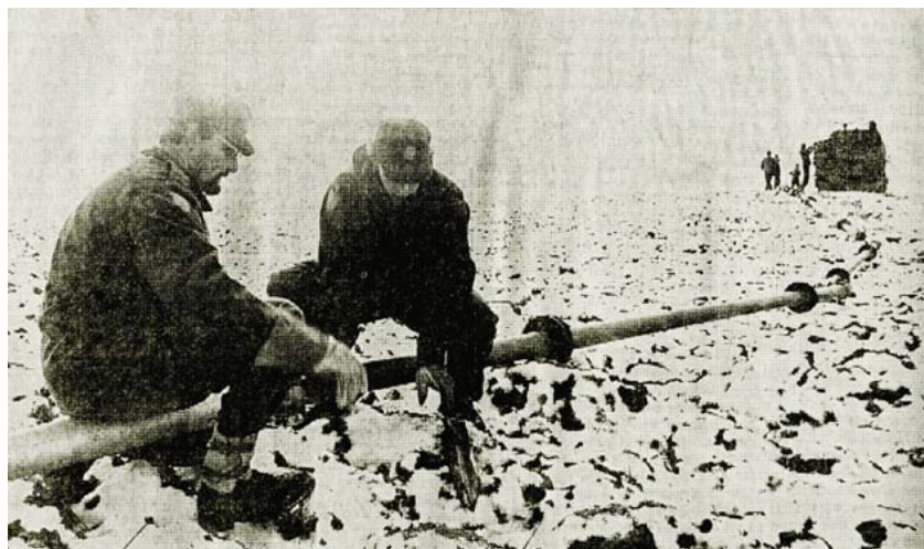
I løbet af weekenden og mandagen udlagde civilforsvaret en 2,5 km lang rørledning fra vandværket i Maugstrup til Simmersted. Foto: Lokallhistorisk arkiv for Vojens-området.
