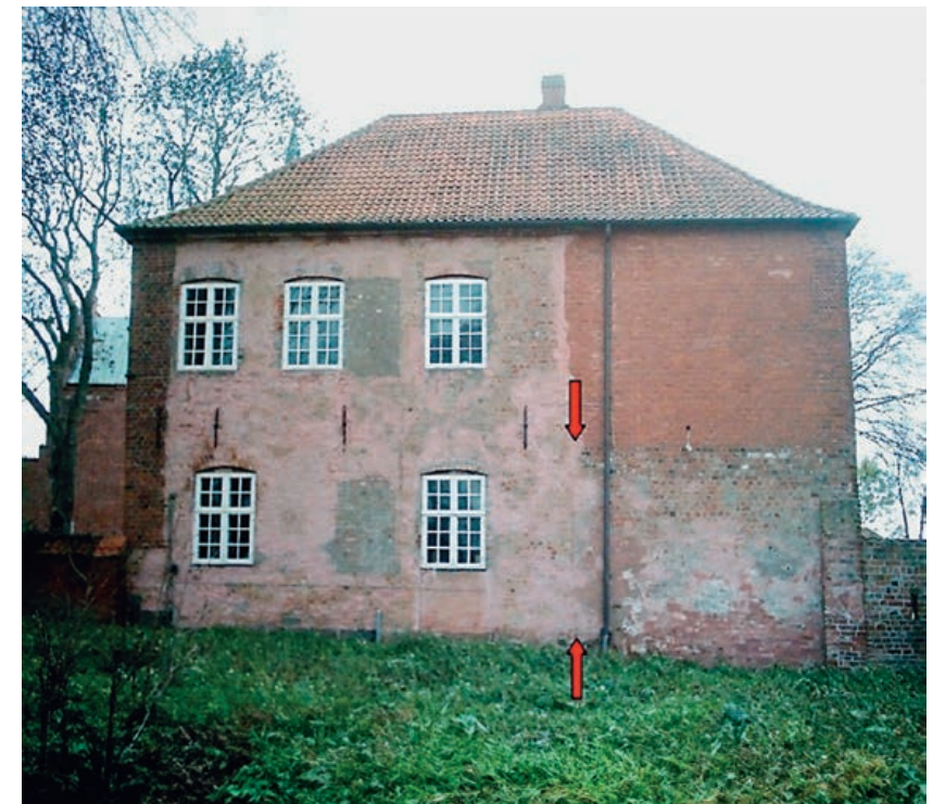
Fig. 8. Slottets vestfacade inden restaurering. Lodfugen ses mellem pilene t.v. for nedløbsrøret. Foto NTS 2006.
