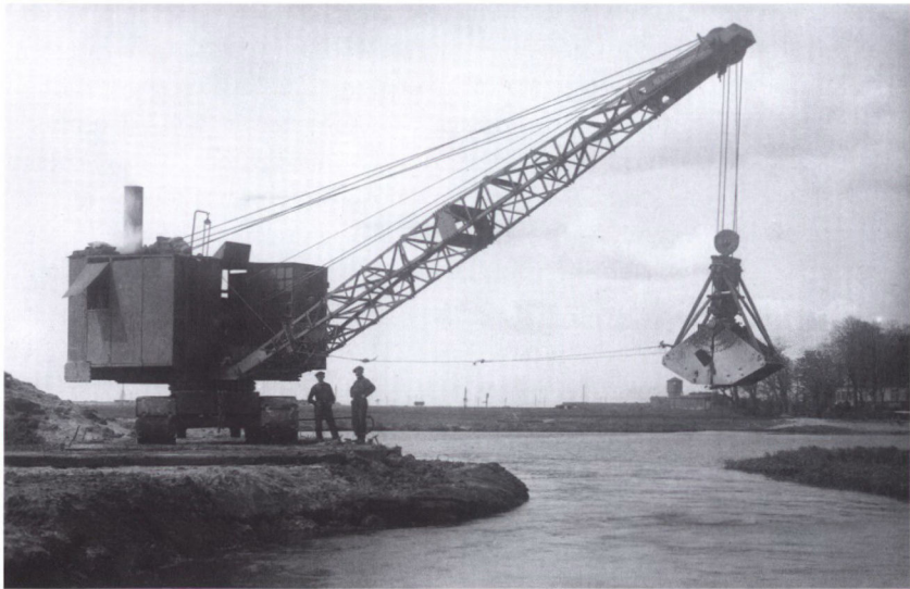
Afvandingsarbejde ved Tønder i 1927. I baggrunden til venstre Tønder Hovedbaneanlæg og til højre Nyholm og vandtårnet. Foto: Tønder Lokalhistoriske Arkiv.
