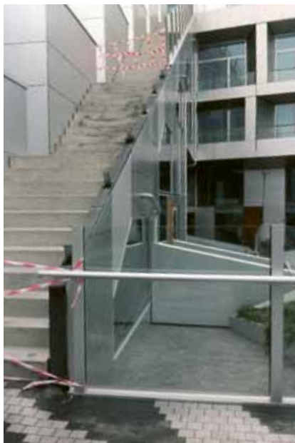
Krisen begyndte at kradse undervejs, så der blev sparet, hvor man kunne, og efterfølgende måtte byggesjusk udbedres i alle tre byggerier. Markedet er medskaber, allerede når arkitekturen tager form, men det er også den kraft, som kan få håndværkere, arkitekter og bygherrer til at tilpasse sig efter bedste evne. Foto fra 8-tallet: Marie Stender.
