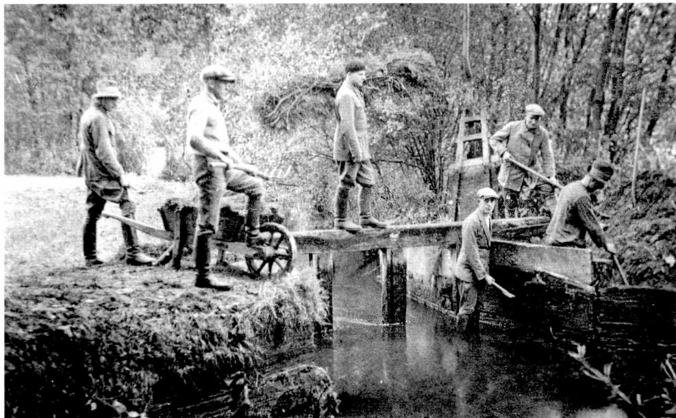
Fig. 6: Elever fra Wiesenbauschule Suderburg reparerer en sluse i nærheden af Suderburg omkring 1930. Foto: Museumsdorf Hösseringen.
