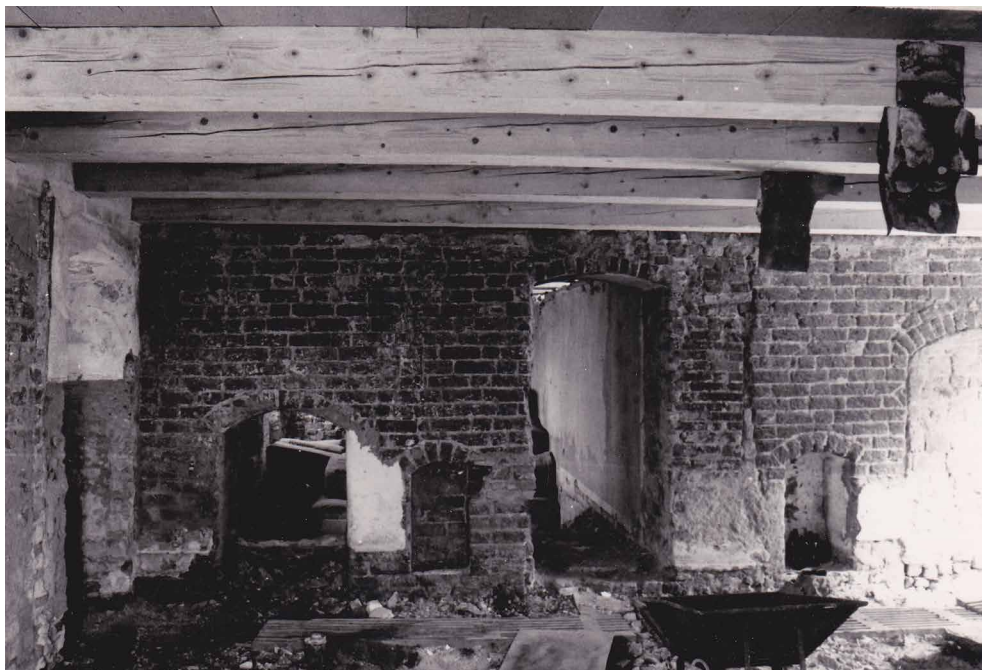
Figur 13. Sydsiden af skillemuren i søndre halvdel af vestfløjens underetage, jf. figur 3. Døråbningen, den lavere muråbning og de to nicher (til bogskabe?) er oprindelige i muren. Midten af skillemuren er nedrevet for at indsætte en nu delvis fjernet skorsten. Igennem skorstensvæggen er brudt en døråbning. Foto: Erik Haubo Christensen 1988. Fotografisk registrering af vestfløj (Foto 1.07). Slots- og Kulturstyrelsens arkiv.
