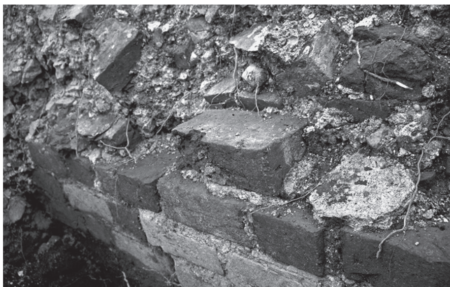
Fig. 17b. Resterne af et vederlag til kælderens flade tøndehvælv i muren mod borggården. Blot en enkelt skrånstillet sten samt en vandret, kileformet fuger til den næste sten er bevaret. Set mod sydvest. – Foto: Jan Kock.
