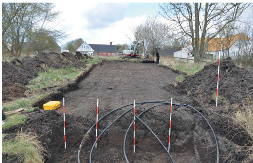
Fig. 4. Afrømning af græstørven over jordvarmeanlæggets tracé. Jordslangerne er markeret med landmålerstokke. – Foto: Museum Østjylland.
