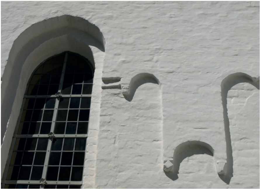
Fig. 7b. Facadens blændingsdekoration er raffineret udført – særligt buefrisen under den oprindelige gesims. Bueslagene har hvilet på konsoller med både geometriske og antropomorfe former. I senmiddelalderen er blændingsdekorationens rytme blevet ødelagt ved indsættelse af store vinduer. – Foto: Morten Larsen 2019.
