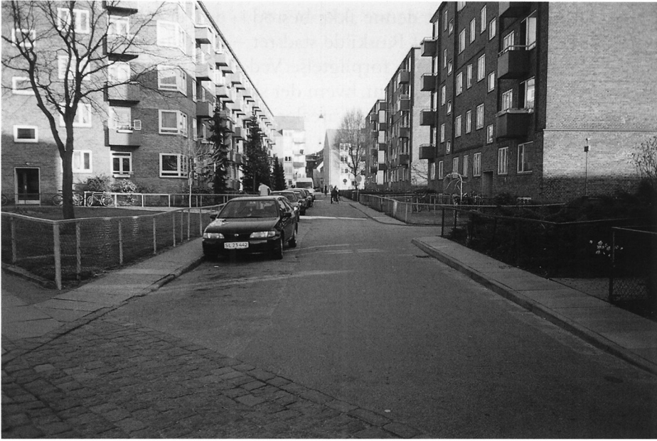
Fig. 23. Der er ikke altid så langt fra middelalderen til i dag. Ålandsgade i København er en privat gade, hvis vedligeholdelse påhviler fem ejerforeninger. Som det ses, er der forskel på højre og venstre halvdel af vejbanen, og højre er nogle cm højere. Kun de fire foreninger på gadens højre side kunne nemlig i midten af 1990'erne blive enige om betalingen for istandsættelsen af vejen, den femte, der ligger på gadens venstre side, ville ikke være med. Foto: Hanne Dahlerup Koch.
