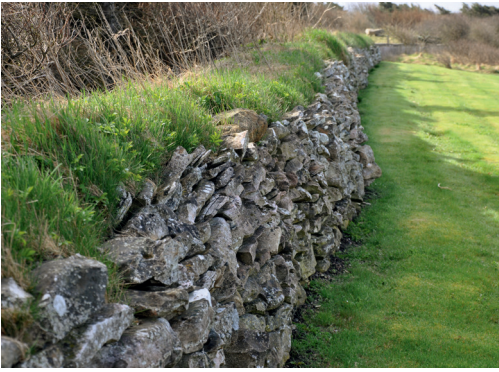
Fig. 4. Vestdige. Hansted Kirkegård. Kalkstenene frostsprænges og diget synker sammen. Foto: Mogens Bjørn Andersen.
