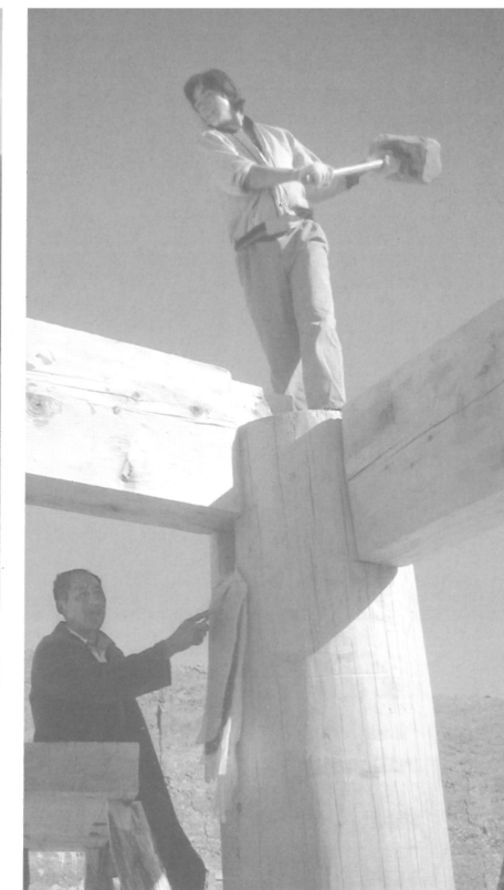
Den vigtigste og tykkeste søjle biga er ved at være på plads.
