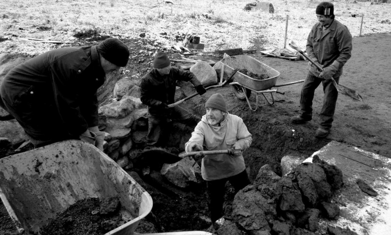
Mænd på fællesarbejde. Det er ikke til at se det endnu, men broen, der her er under opførelse, kommer til at udtrykke sjæl. Foto: forfatteren.
