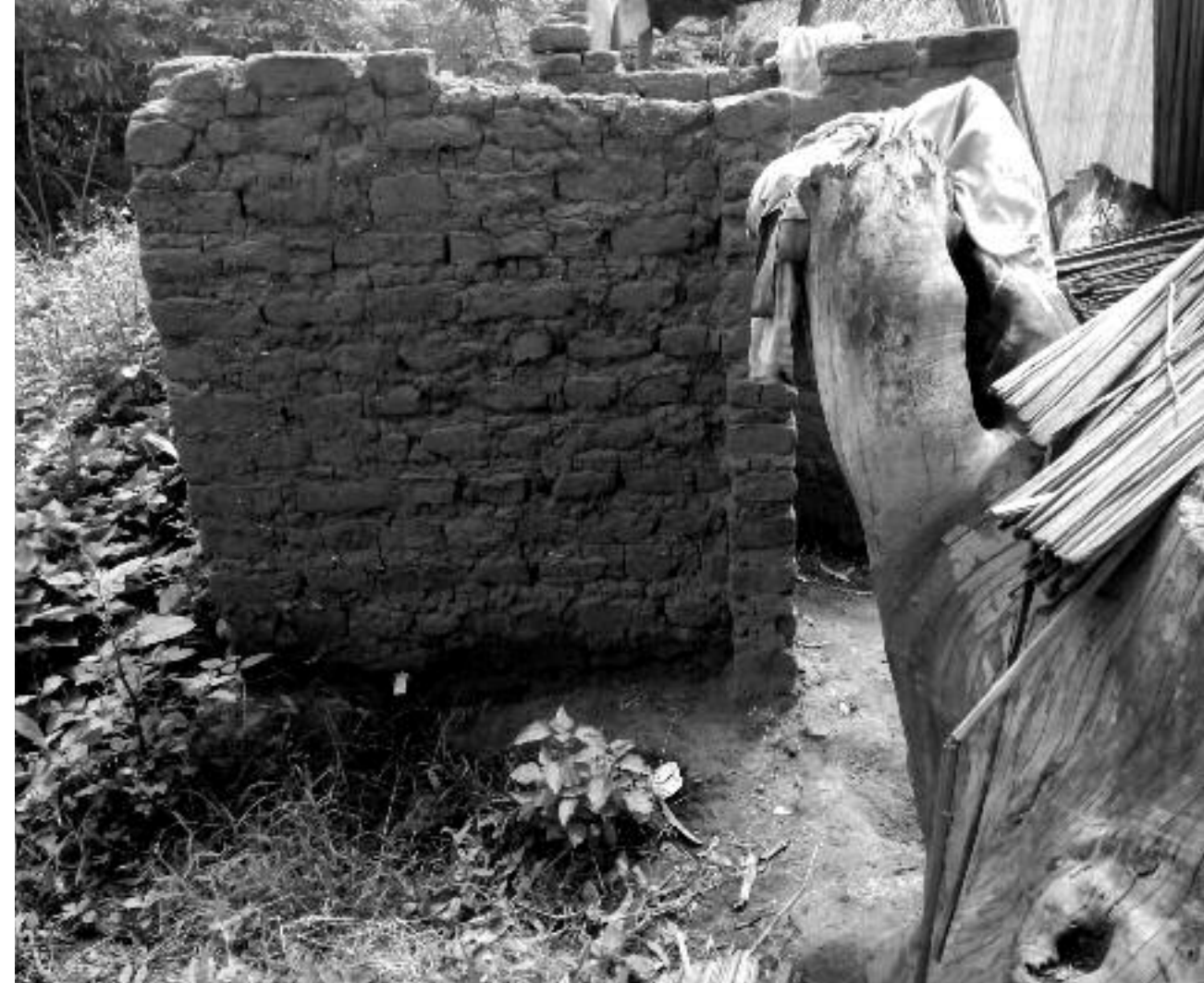
Hjemmet på grænsen – her ses en del af Alices konstruktion. Foto: Mette Lind Kusk.
