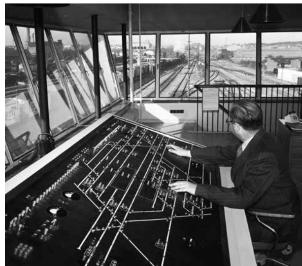
Fra tidligt i 1950'erne arbejdede DSB på at forbedre sikkerheden og effektiviteten på banenettet. Her er vi i den nye signalpost på Odense Banegård i 1954. Sikkerhedsassistenten sidder ved betjeningstavlen til relæsikringsanlægget (Jernbanekilder.dk/Danmarks Jernbanemuseum).
