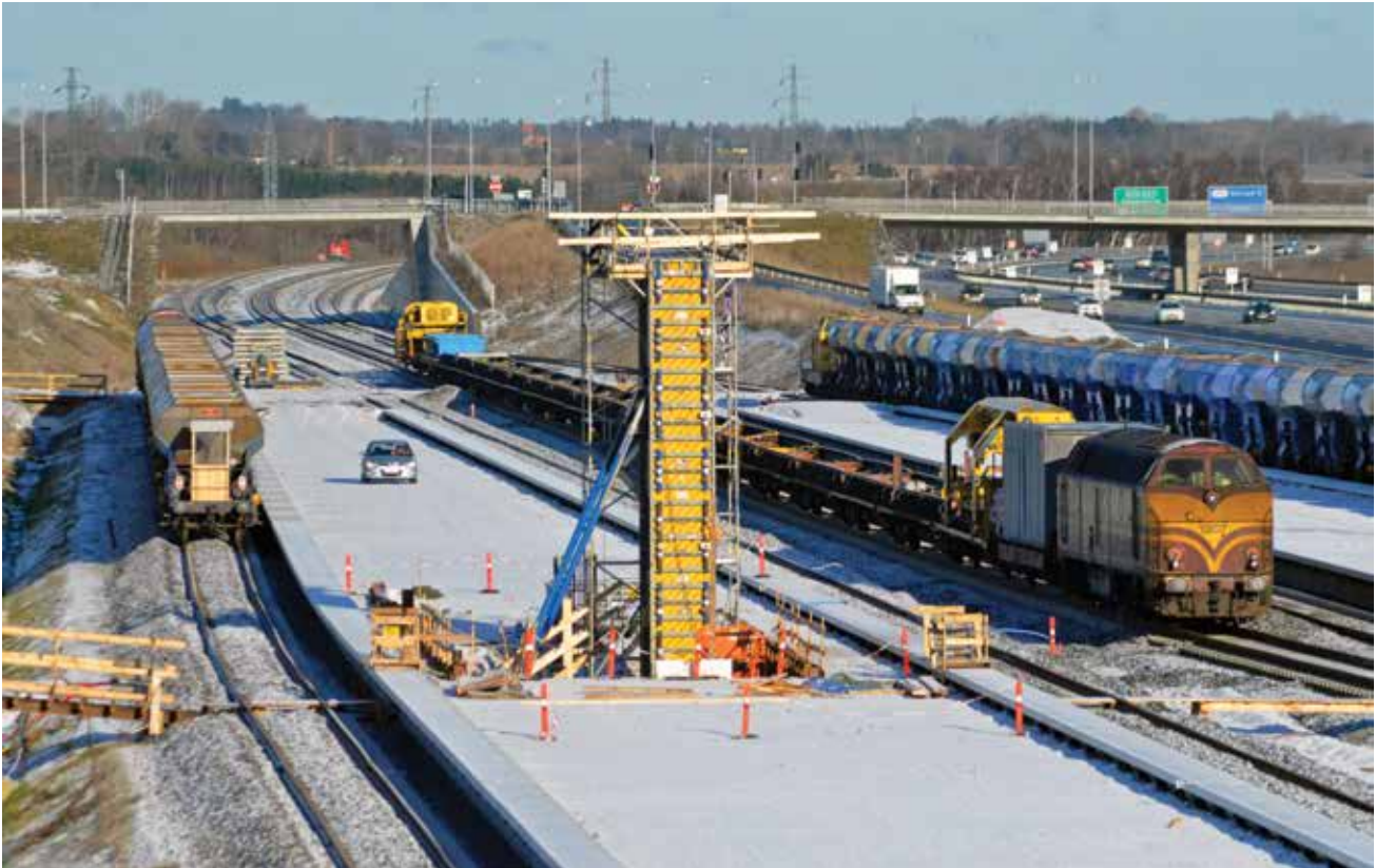
Den nye station i Køge Nord – på strækningen København-Køge Nord-Ringsted – under anlæggelse i januar 2017. På et af sporene ses et tidligere luxembourgsk lokomotiv tilhørende CFL Cargo Danmark (foto: forfatteren).
