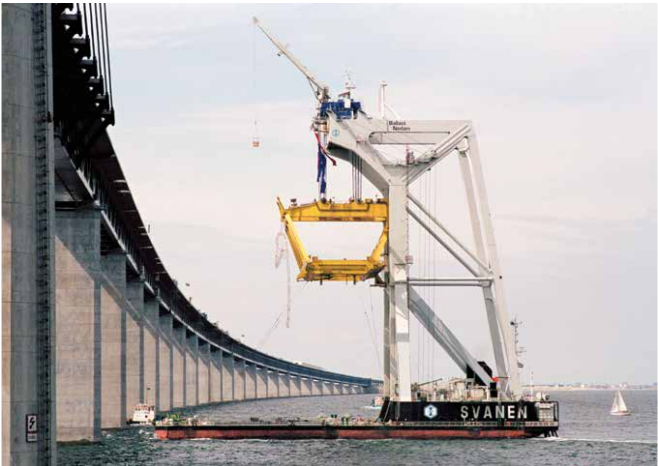
Flydekranen Svanen under opførelsen af Øresundsbroen. Flydekranen blev bygget i Holland i 1990 i forbindelse med anlæggelsen af Storebæltsforbindelsen. 13. august 1999, Svanen har netop placeret den sidste brosektion (foto: René Strandbygaard, 1999)
