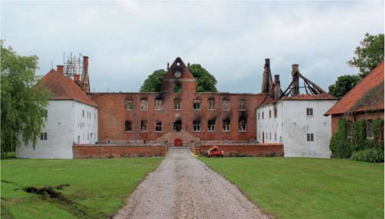
Dagen før stilladserne skulle være fjernet, slog et lyn ned i stilladset ved den sydvendte gavl, og hovedbygningen udbrændte den 20. juni 2013. Foto: Niels Peter Stilling.
