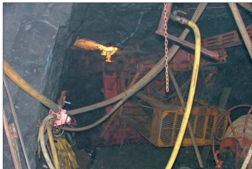
En alimak kørt ud af skakten. I øverste højre hjørne ses skinnen, som er boltet til taget. Den lodrette røde plade bagerst er platformen, som minearbejderne kravler op på, efter at have siddet i det orange bur på vejen op til fronten. (Foto: Forfatteren)
