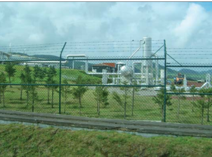
Område 2 – Det geotermiske anlæg ved Lagoa do Fogo. (Foto: forfatteren)
