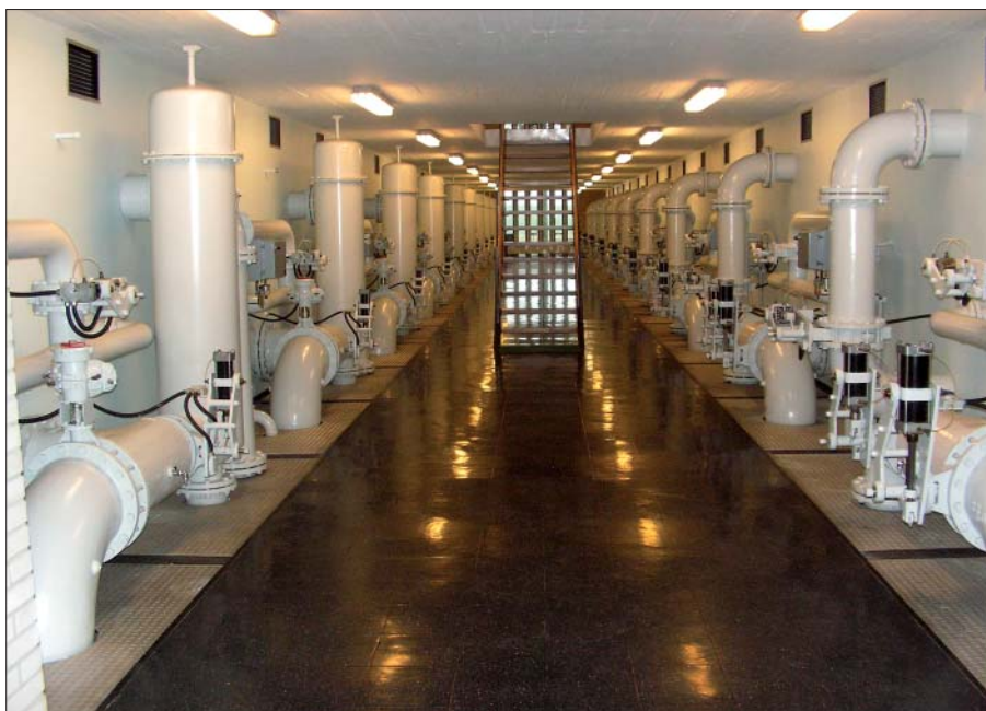
Filterfront på Højballegårdværket. Filtrene har en behandlingskapacitet på ca. 1.100 m 3 /time. (Foto: UVH)
