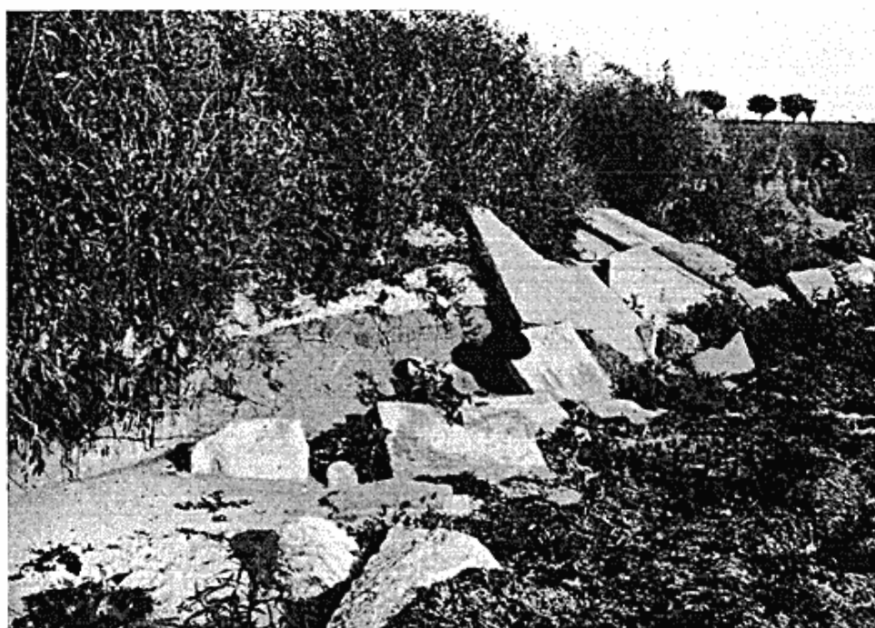
Fig. 3. Rester af tangdige og kystbeskyttelse af betonfliser på vestkysten af Askø. Det ses, hvorledes vandet skyller ind bag fliserne, mens vegetationen i forgrunden ud mod vandet er intakt.
