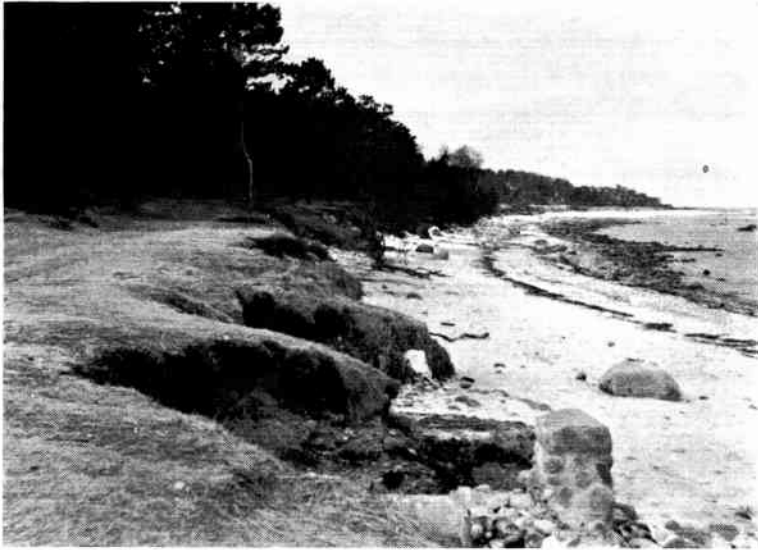
Fig. 7. Stærke storme i vinteren 1961-62 har angrebet kysten, og denne er rykket så meget tilbage, at munden af afløbet fra bebyggelsen ved Kildekrog er kommet til at stå 2 m foran klinten. 20. 2. 62, foto 4214.
