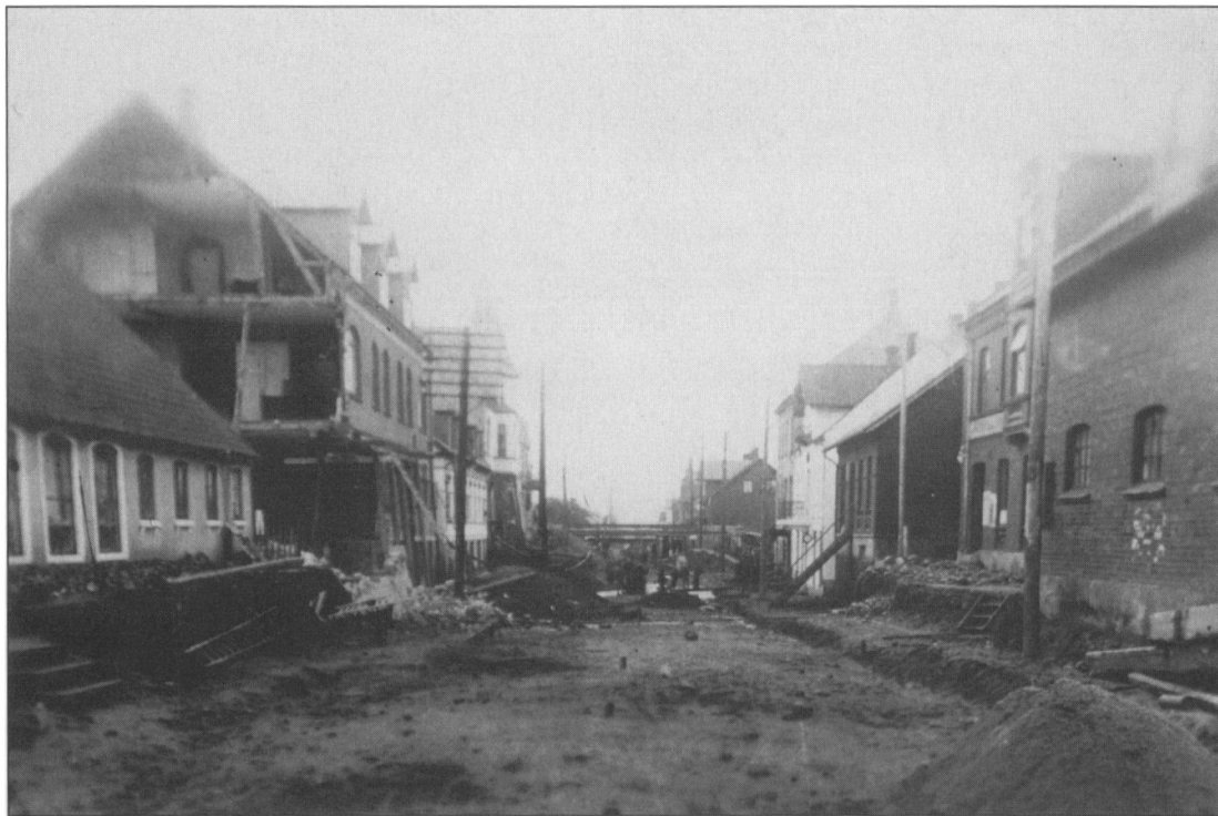
Brørup 1918. Søndergade i opbrud. Gaden blev gravet op og ført som viadukt under banen. Herved vandt enkelte huse nær banen én etage ekstra, til gengæld styrkede gavlpartiet på det store hus til venstre sammen. Til højre afholdshotellets stald. Foto i Historisk arkiv for Brørup og Omegn.
