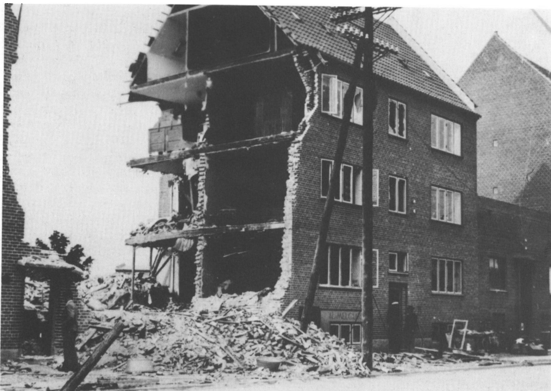
De ødelagte ejendomme i Frodesgade fotograferet et par dage senere, hvor det første oprydningsarbejde var overstået. (Byhistorisk Arkiv Esbjerg).
