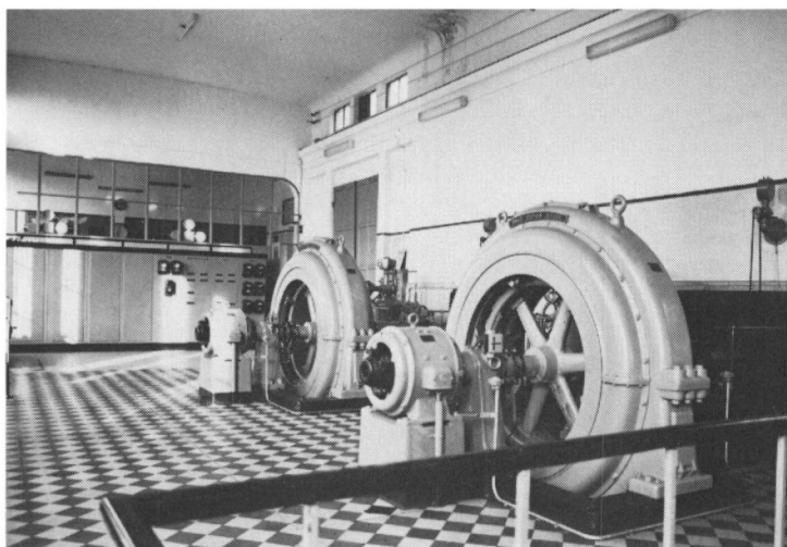
Fig. 1. Fra maskinhallen. I forgrunden de to Titangeneratorer fra 1920, i baggrunden ses manøvrerummet. Foto forf.
