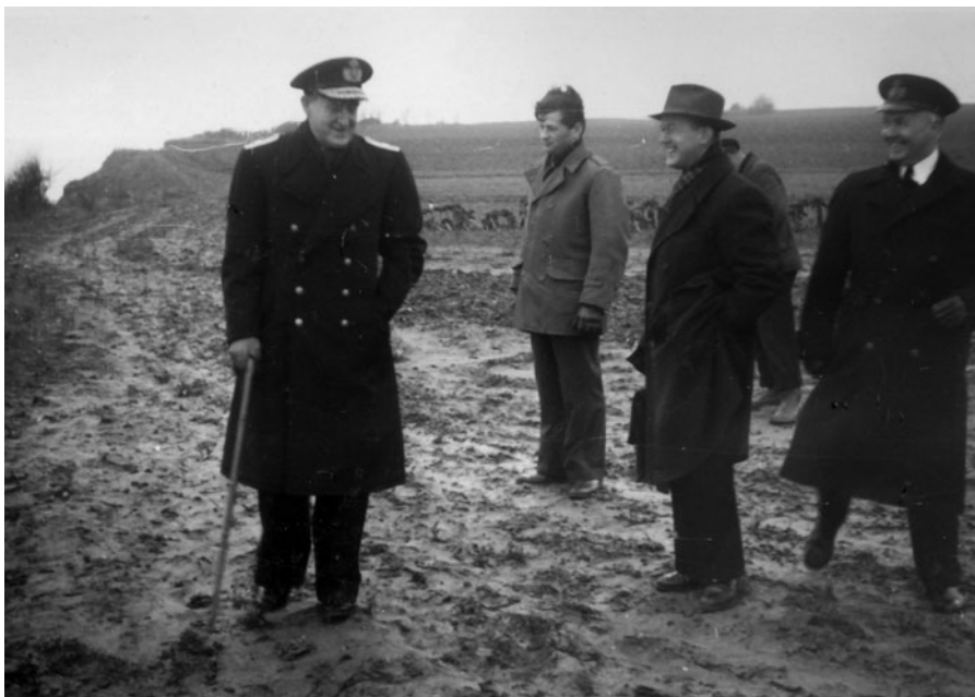
Kystbefæstningens dynamiske chef, kontreadmiral Eyvind Musaeus Dahl, og civilingeniør Gottschalck-Andersen fra Søværnets Bygningsdistrikt inspicerer det første spadestik for byggeriet af Stevnfortet 7. januar 1952. Gottschalck-Andersen havde tidligere på året været på studietur til England for at studerede et kystanlæg i Dovers høje kalkklipper. (Forsvarets Bibliotek)
