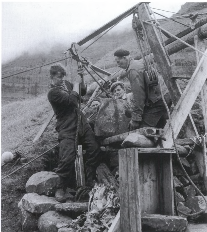
Fig. 3. Hejseapparatet monteres, 1961. Det færøske hus, som Bjarne Stoklund havde købt til Frilandsmuseet, lå på et meget utilgængeligt sted og det krævede både snilde og slid, at få det bugseret over i det skib, der skulle fragte det til København (foto i privateje).
