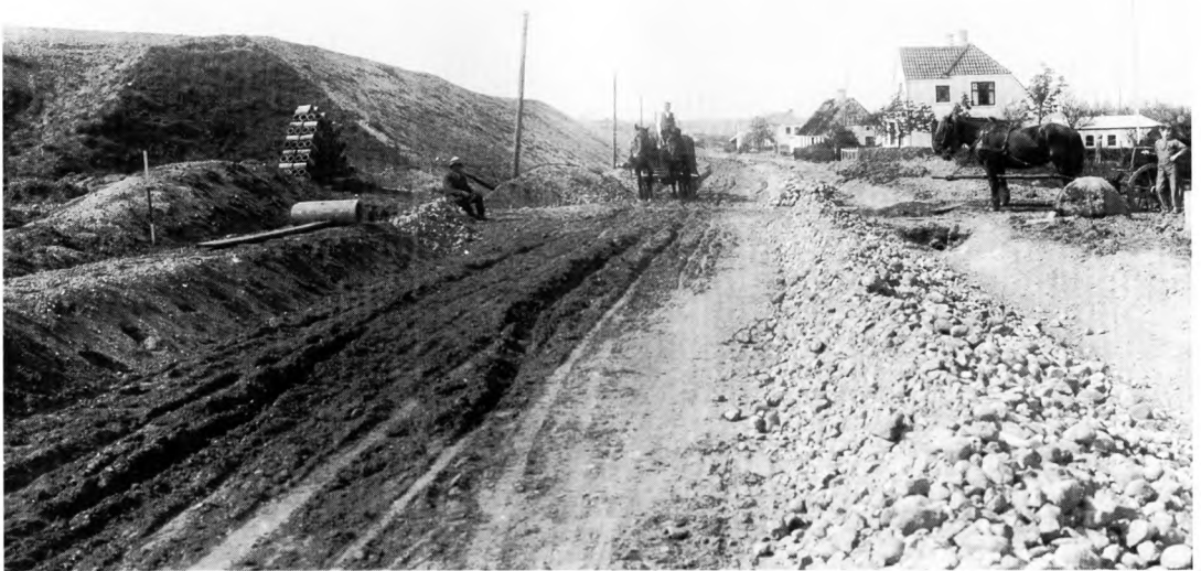
Anlæggelsen af en ny vej i Dover, Lintrup sogn i Haderslev. Billedet er udateret, men formentlig taget efter Genforeningen. Foto: Institut for sønderjysk Lokalhistorie.
