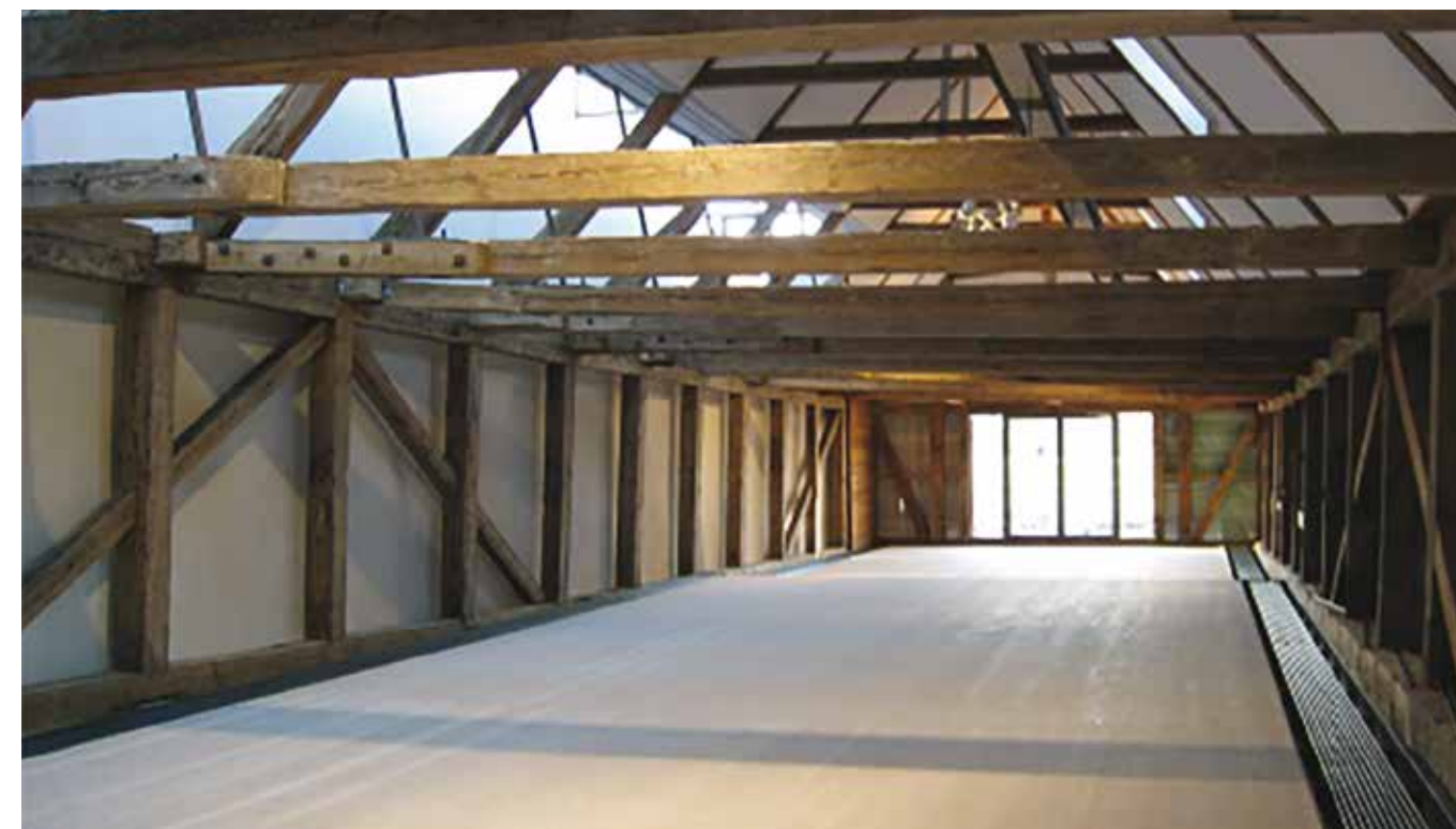
Søndre Masteskure. Fredningsmyndighederne stillede krav om, at den indvendige bindingsværkskonstruktion skulle kunne opleves i sin helhed efter konverteringen fra koldt til varmt hus. Her ses isoleringen med termoglas indvendigt beklædt med lærred. Det oprindelige skrånede fald ned mod havnen er markeret med trin, således at man bevarer niveauforskellen med plane gulvflader. Foto: Slots- og Kulturstyrelsen.
