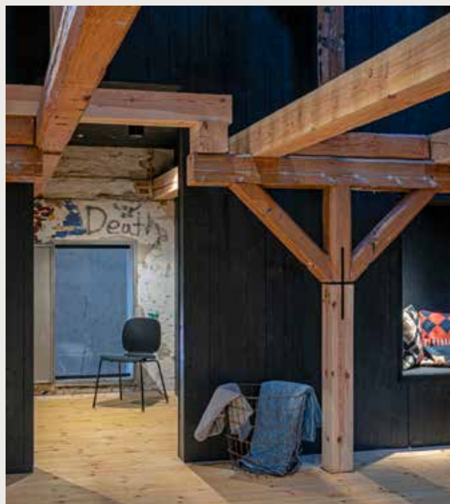
De lave etagehøjder i det oprindelige pakhus har medført, at det flere steder har været nødvendigt at skære bærende bjælker over og lave udvekslinger, der tillader passage på tværs af længderetningen. Foto: Jens Markus Lindhe.
