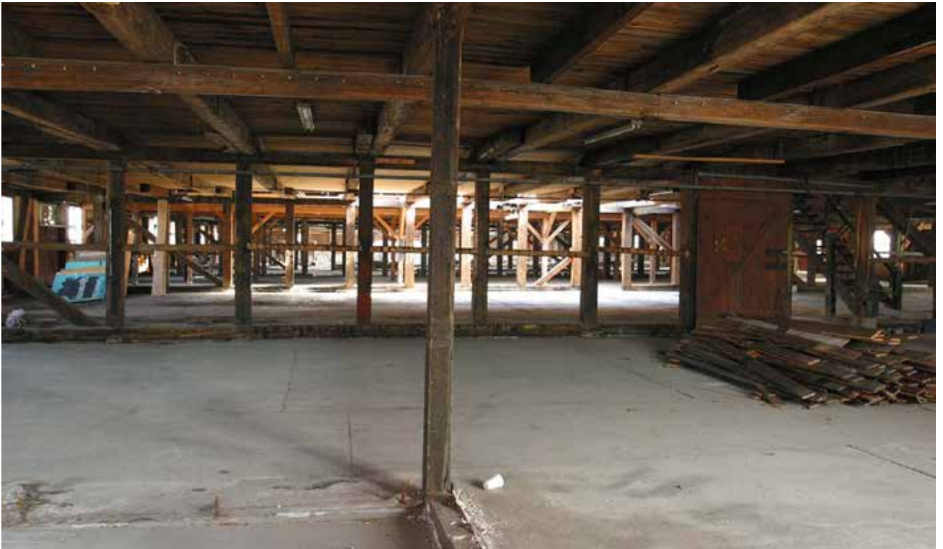
Søndre Masteskure - Den indvendige bindingsværkskonstruktion før restaureringen. Fotograf: Andreas Trier Mørch / Arkitekturbilleder.dk
