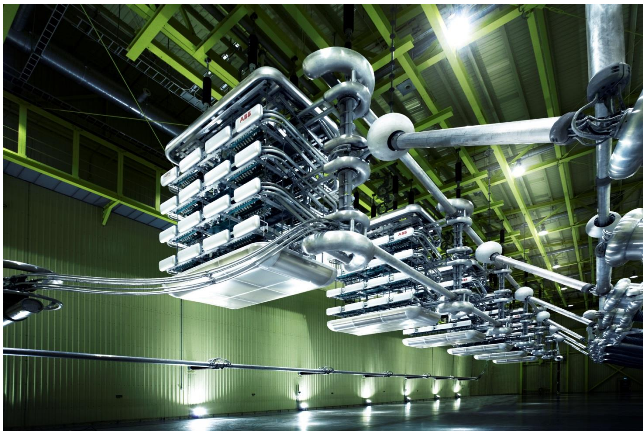
Hal med tyristorer i en transformatorstation for omdannelse af højspændt vekselstrøm til jævnstrøm. Kilde: Wikimedia Commons.
